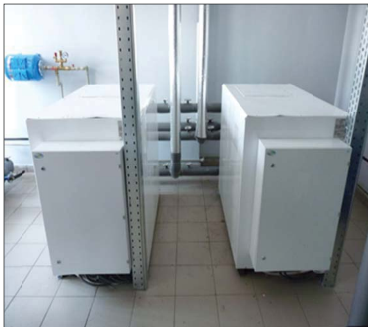
Рис. 1. Внедрение энергоэффективной системы отопления административно-бытового корпуса (АБК) СМП-655 при помощи двух тепловых насосов.
