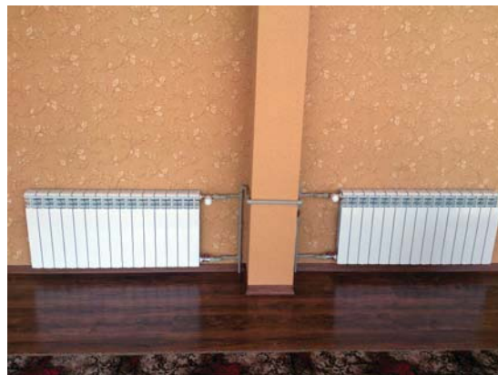
Современные приборы отопления
