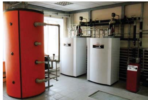
Тепловые насосы РПЧ, г. Полтава
