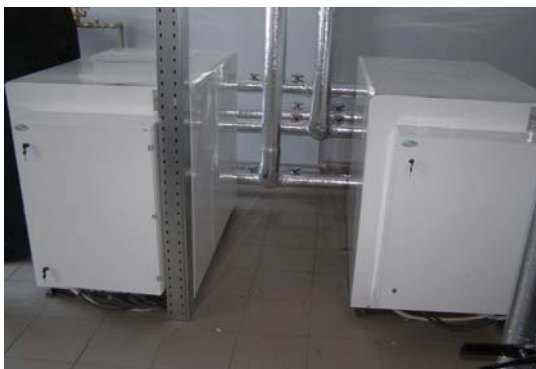
Тепловые насосы в БМЕУ, г. Харьков
