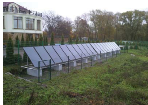
Солнечные батареи, г. Миргород
