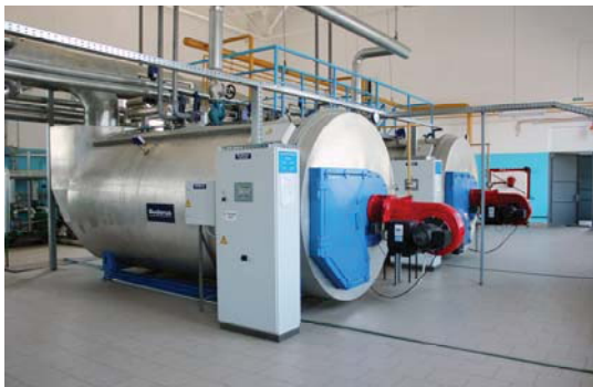
Современная котельная ВЧД г. Купянск
