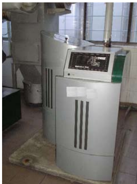
Рис. 1. Общий вид котла
