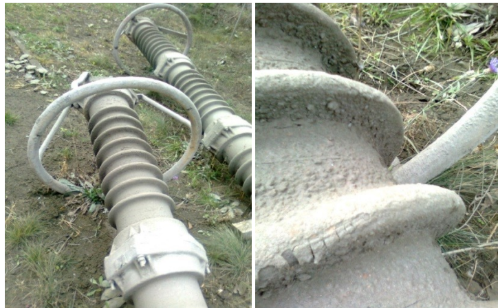
Рис. 1. Забруднення на поверхні розрядника демонтованого на ПС 110/35/6 кВ «Здолбунів-ЦШК»
