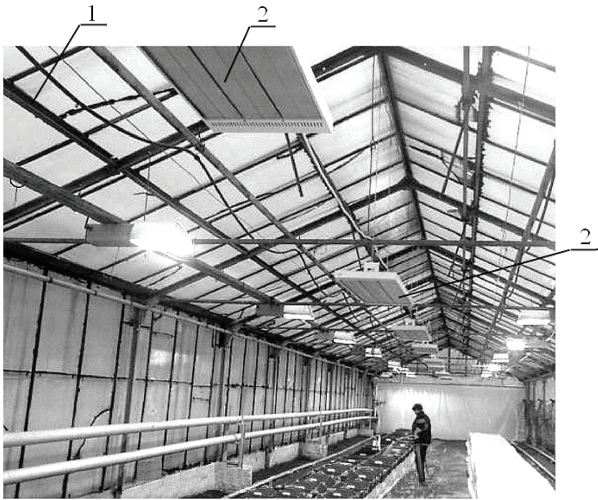
Рис. 2. Инфракрасное отопление теплицы с использованием электрических длинноволновых трехпанельных нагревателей: 1 – конструкция теплицы; 2 – электрические длинноволновые нагреватели
